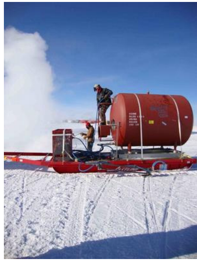
图 8 施工人员正在南极冰原上使用专门的热热水钻孔设备打洞
