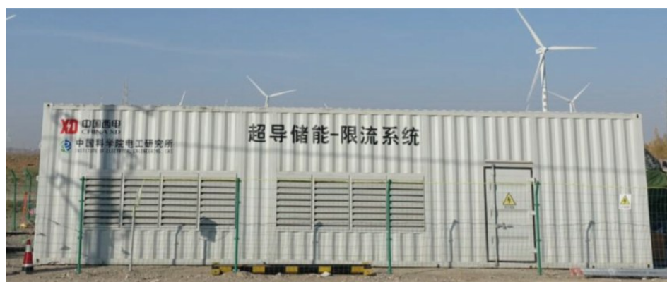
图8 1 MJ / 0.5 MVA超导储能—限流系统在玉门风电场并网试验现场
