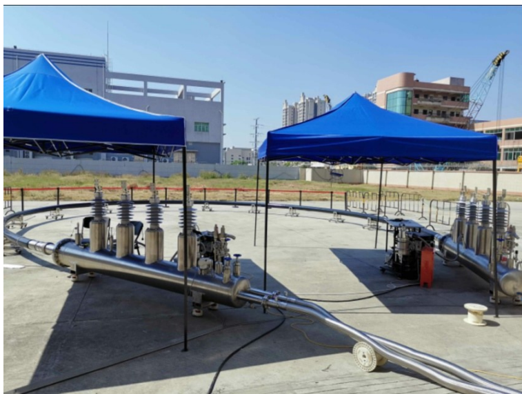
图2 深圳平安中心高温超导电缆
