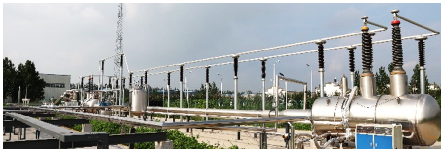
图4 30 m长, \pm 100 kV/1kA 超导直流能源管道测试现场
