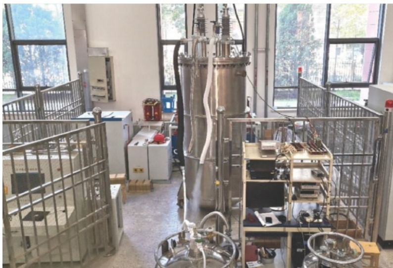
图6 40 kV/2kA 超导直流限流器试验现场
