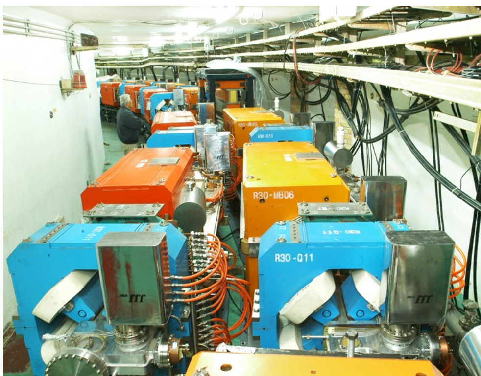
图2 BEPCII双环隧道
