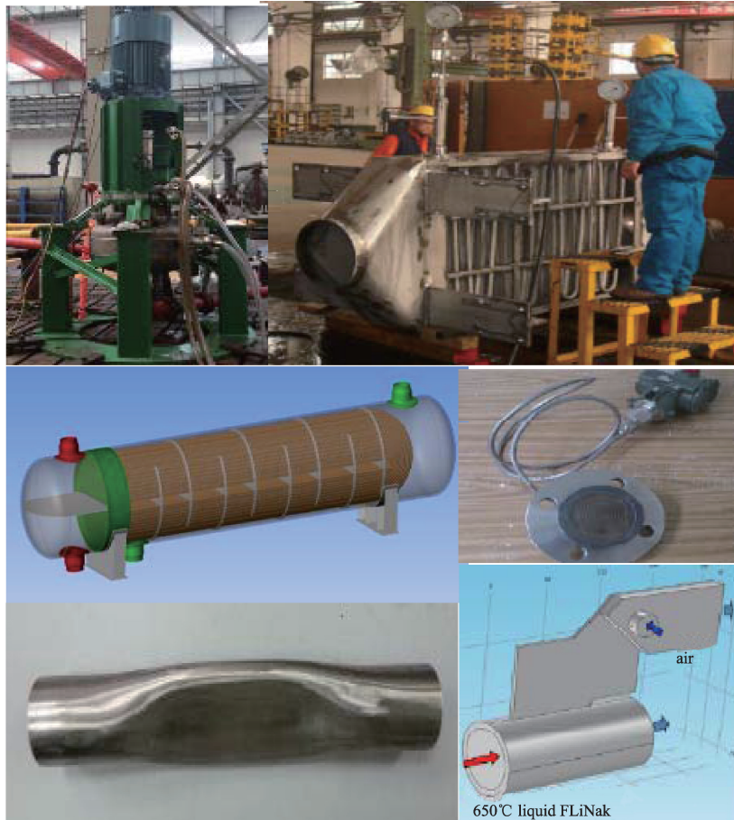
图7 氟盐体系泵、阀、换热器
